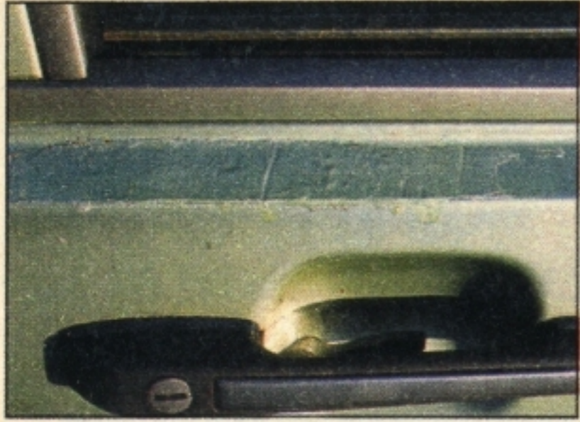
Tür: Hier wurde schon kräftig über den Rost gespachtelt
